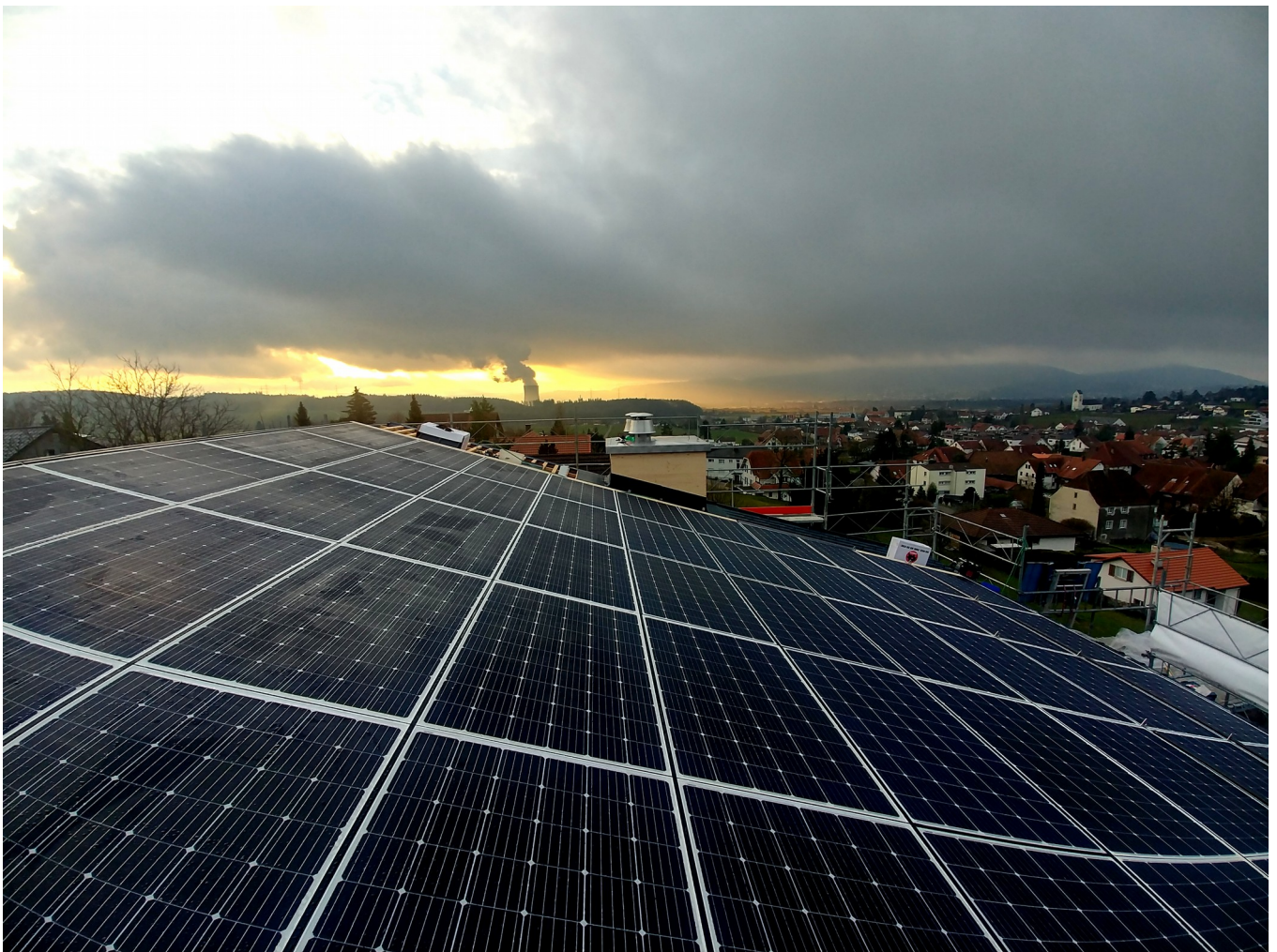
Abbildung 1: Photovoltaik-Indach-Anlage in Lostorf, in der Nähe des AKWs Gösgen.
