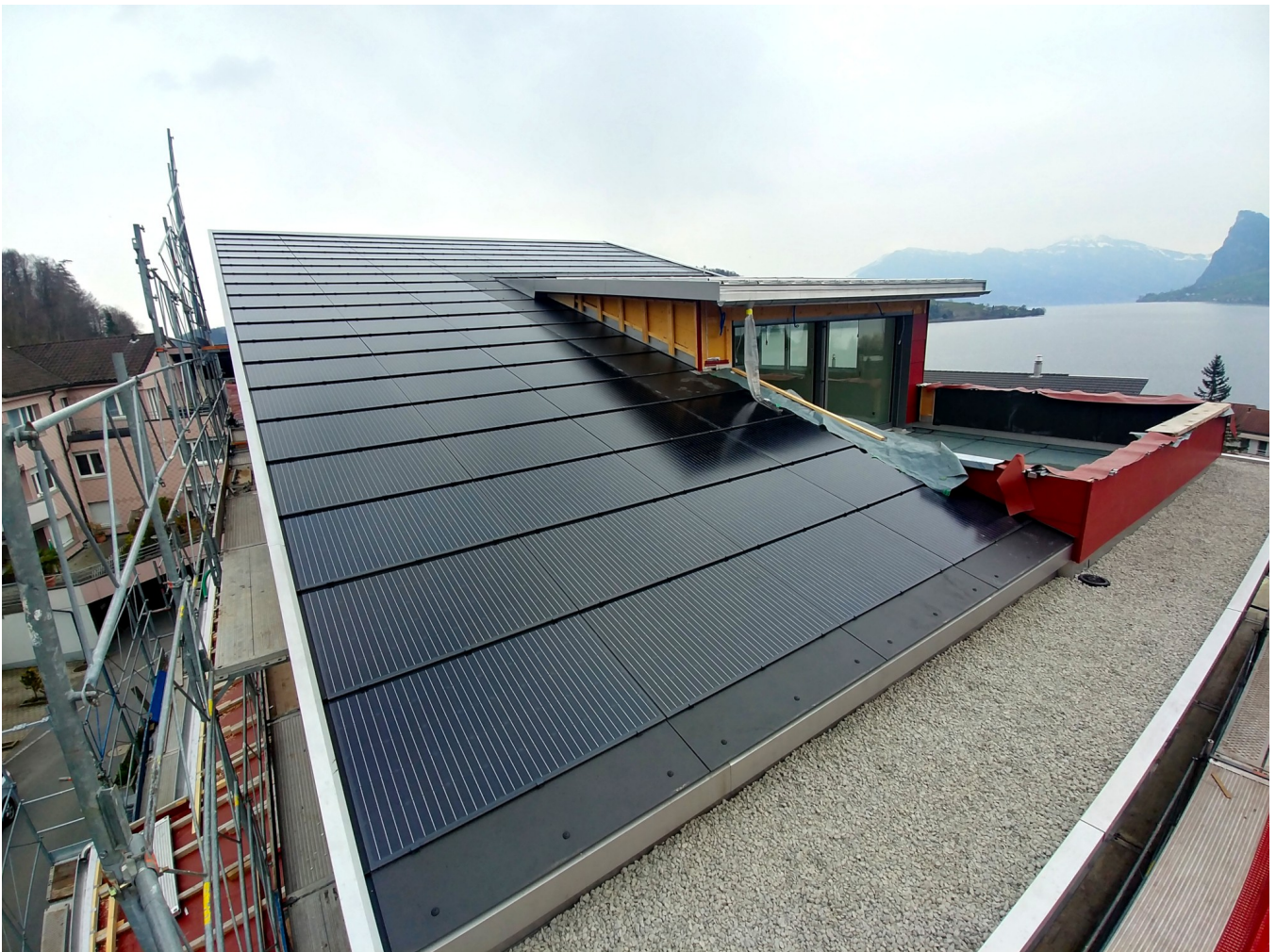
Abbildung 4: Indach-Photovoltaik-Anlage in Hergiswil, realisiert durch die Energie Genossenschaft Schweiz
