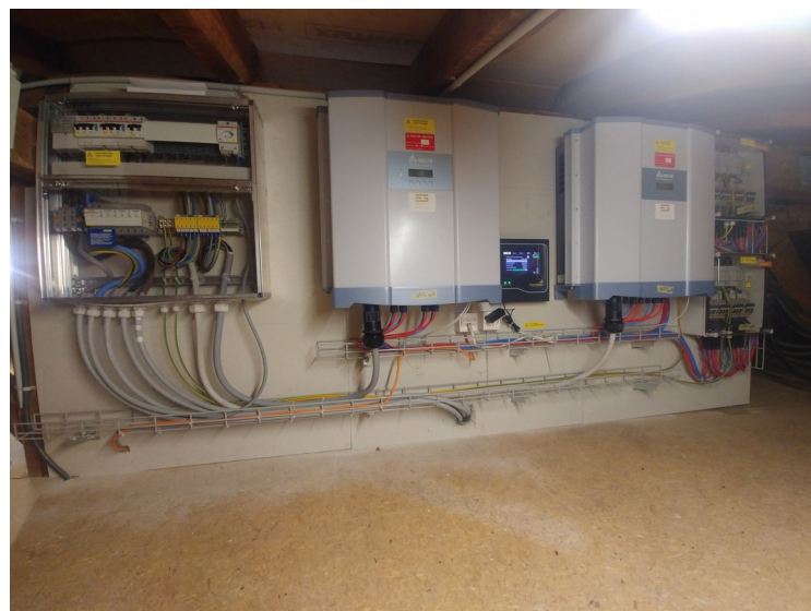
Abbildung 2: Für die Installation von Wechselrichter und elektrischer Unterverteilung greift die Energie Genossenschaft Schweiz oft auf die Unterstützung des Elektrikers zurück.
